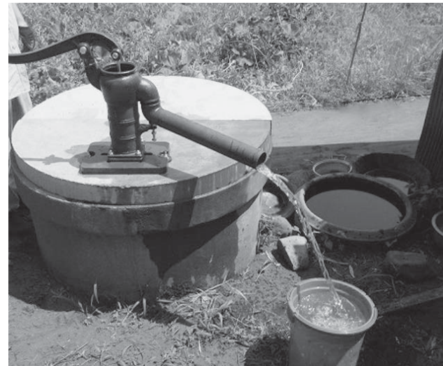
災害時の生活用水として見直されている井戸
