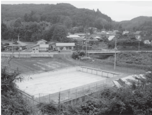
使用不能になっている生瀬中学校プール
