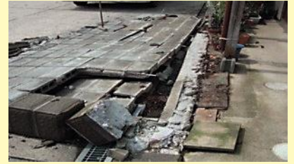
倒壊したブロック塀*
