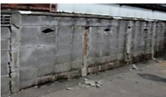
劣化したブロック塀*
