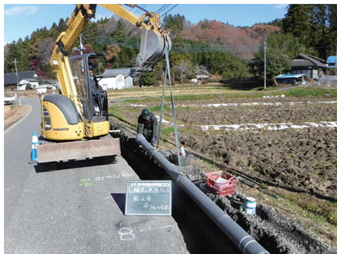
水道施設の整備
