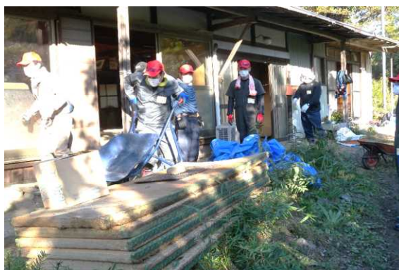
浸水した家財の搬出作業
