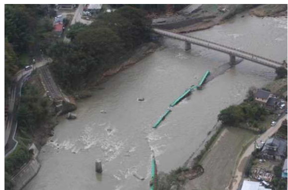
被災後の水郡線第六久慈川橋梁
