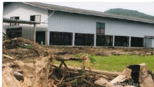
サッシの割れた牛舎
