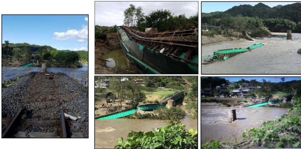
【2019.10.13 撮影 第六久慈川橋梁・崩落】
