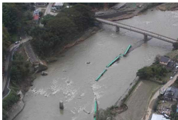
被災後の水郡線第六久慈川橋梁
