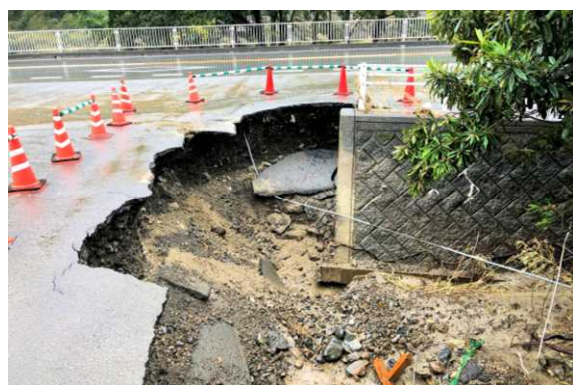
路体流失（盛金地内）
