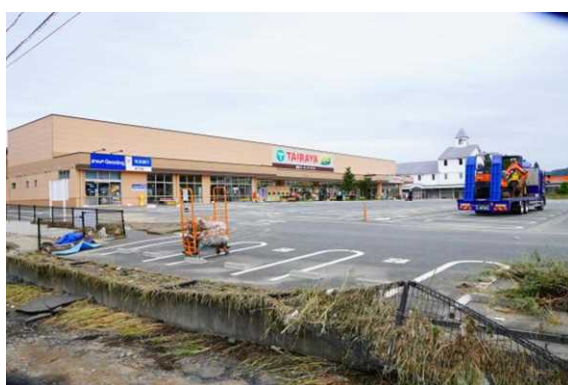
水のかで倒れたフェンス ※
