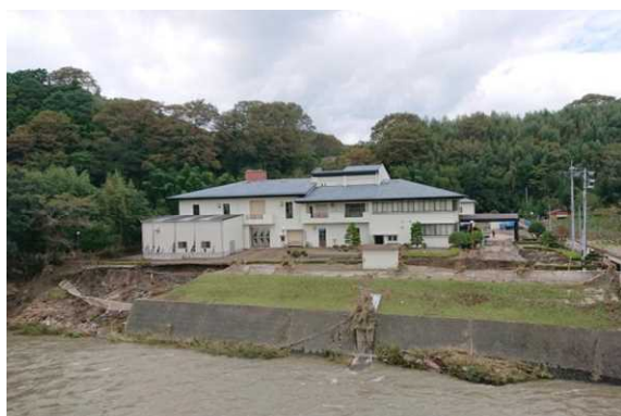
完全に機能を喪失した衛生センター （南田気地区）
