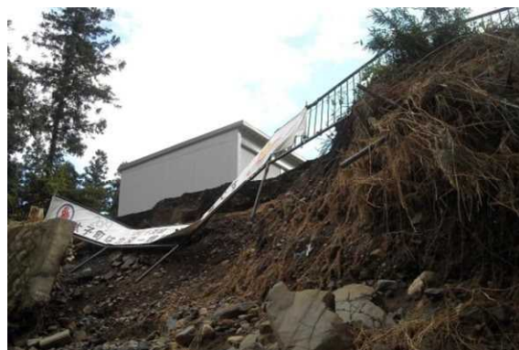
奥久慈溪谷駐車場護岸破損（袋田地区）
