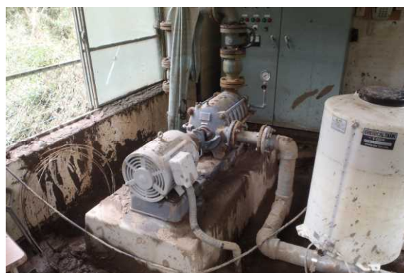
被災した西金浄水場送水ポンプ
