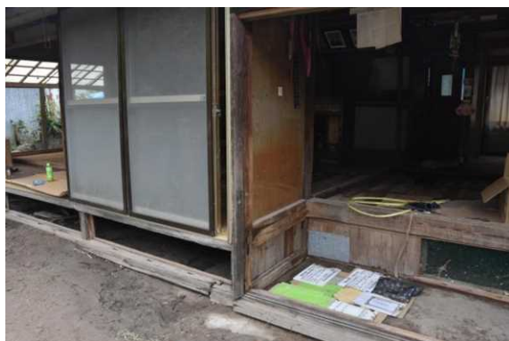
床上浸水となった住家（下野宮地区）
