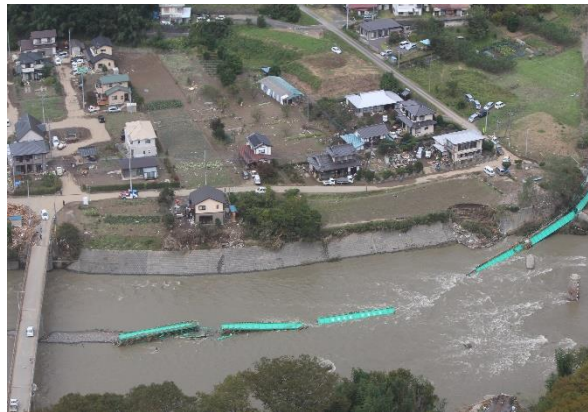
JR水郡線南田気鉄橋崩落
