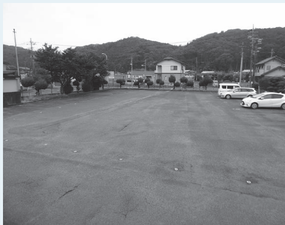
区画線が消えているやみぞの駐車場
