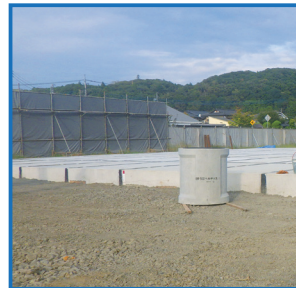
中心市街地排水処理 排水ポンプ2台、地 ※令和7年
