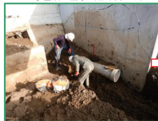
U型側溝を排水施設に接続しています
